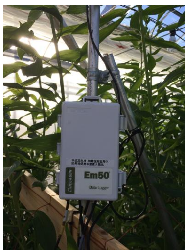
図 10 各種データを記録するデータロガー（このこれに記録されたデータがインターネット経由でクラウドサーバに自動送信される）
