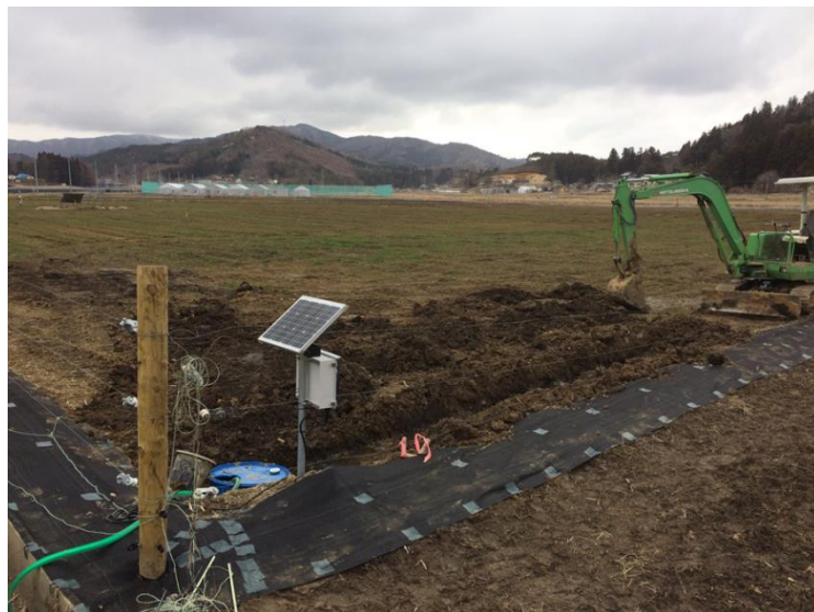
図 16 放牧地に設置されたソーラーポンプ排水システム。明渠に貯まった水の水位を検知し、HALKA を使って圃場外へ排出するポンプを遠隔で作動させる。
