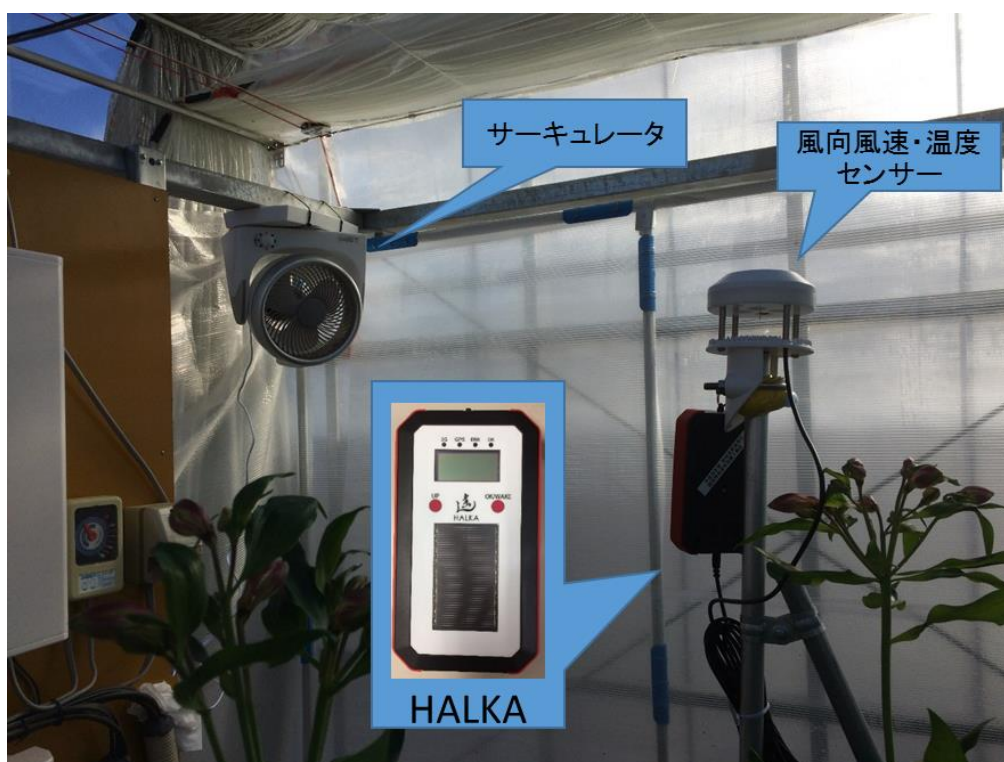
図 12 ハウスに設置された遠隔サーキュレータシステム。HALKA に接続された風向風速・温度センサーが 10 間隔でデータをクラウドサーバに送る。ユーザは携帯端末でデータを確認して必要に応じてサーキュレータのスイッチを ON/OFF する。
