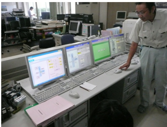
(図.1 操作室のコンピューター)
