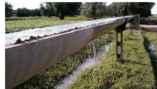
掛樋からの漏水の例（スリランカ）
