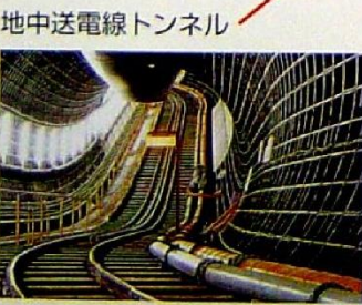
地中送電線トンネル
