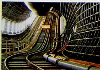
地中送電線トンネル
