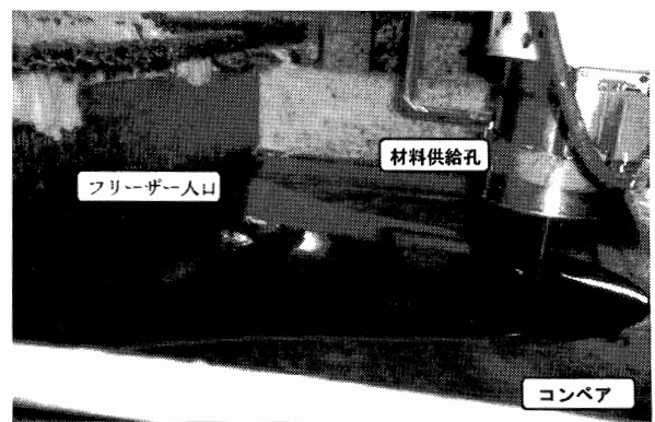
図5 予備冷却したコーヒー濃縮液のトンネルフリーザーへの供給 (冷却空気温度: -40℃)
